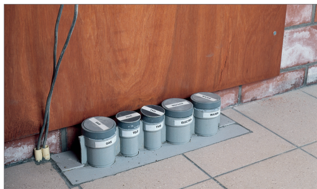
Toegangsopeningen van de energiebocht in de woning
