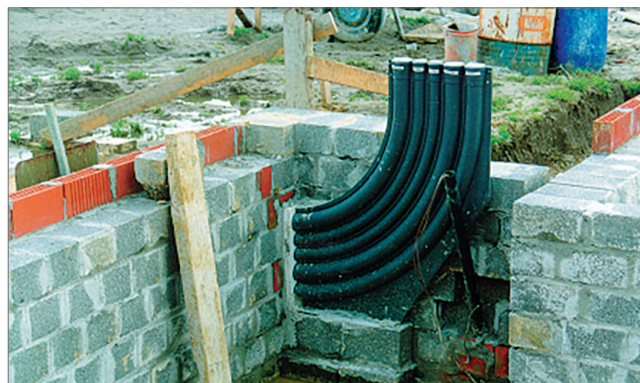
Energiebocht in fundering met kruipruimte
