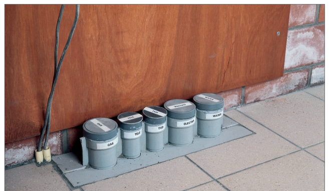
Toegangsopeningen van de energiebocht in de woning
