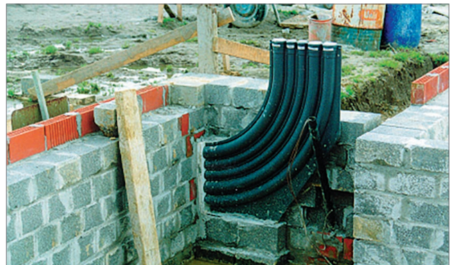
Energiebocht in fundering met kruipruimte
