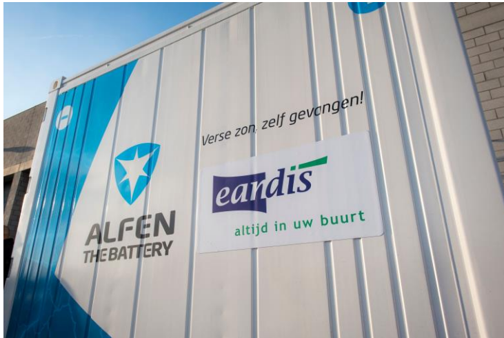
batterij voor energieopslag (Lokeren)
